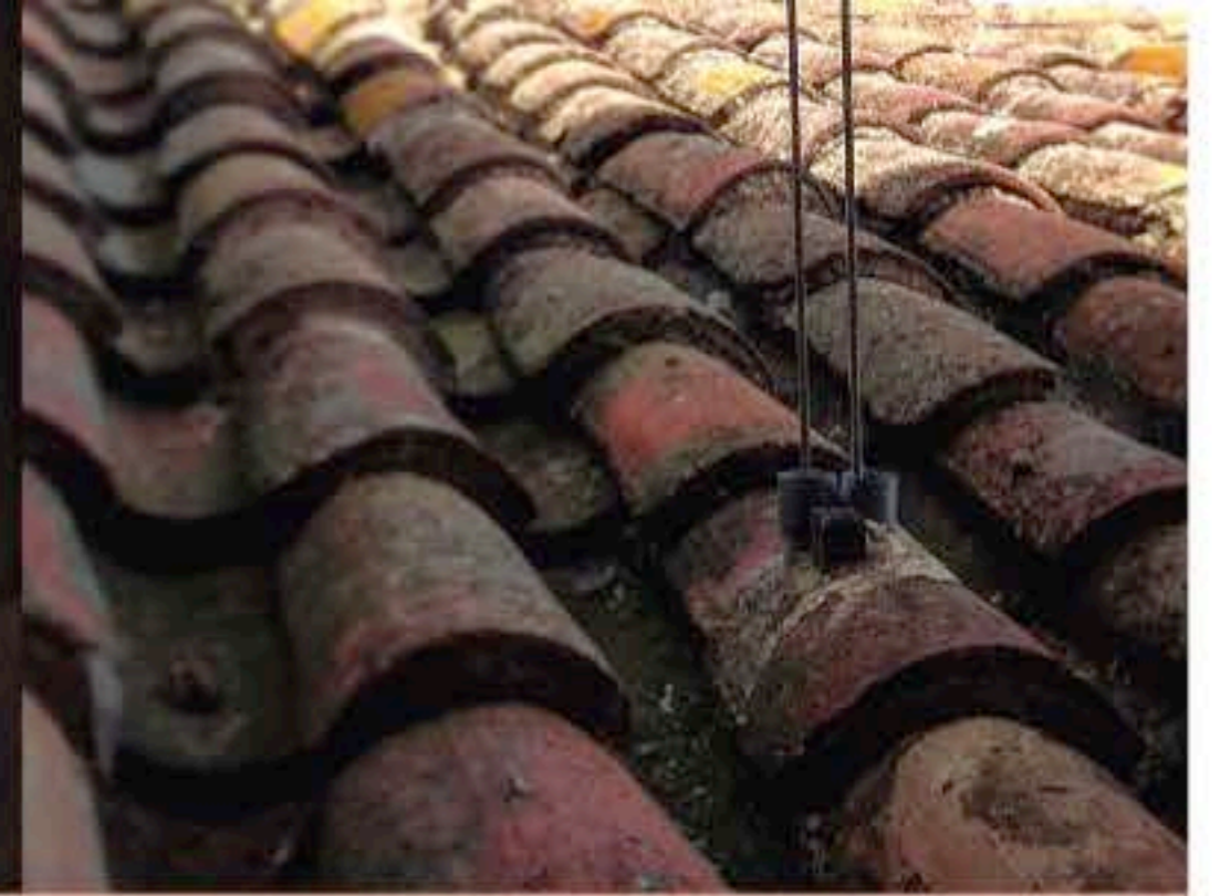
Corda de la campana que travessa la teulada
